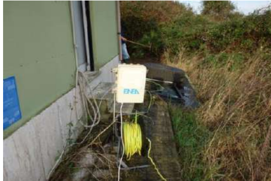
FIGURA 17: NODO MULTIPARAMETRICO PER LA MISURA DI INQUINANTI POSIZIONATO A NNE RISPETTO ALLO SCARICO DEL VELIVOLO, OLTRE IL MANUFATTO IN CEMENTO ARMATO.
